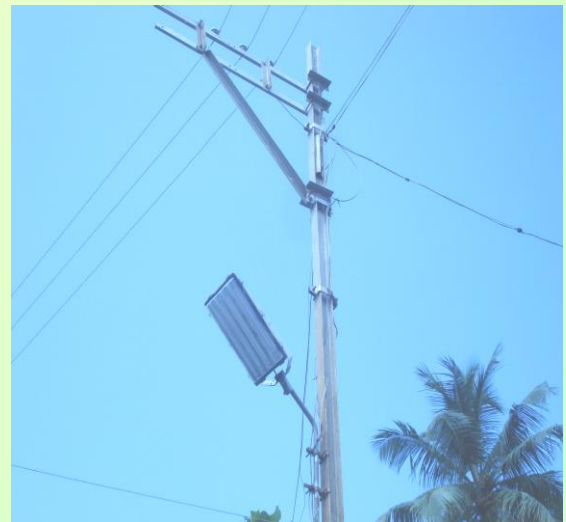
Fig: 2 (New 1 x 24 W T-5 luminaire)
