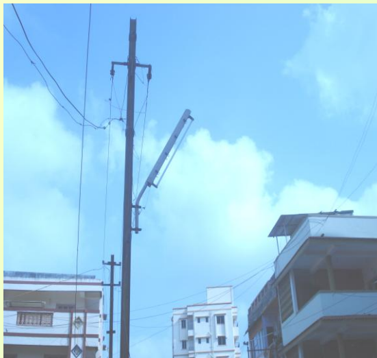
Fig: 1 (Old 1 x 40 W T-12 luminaire)
