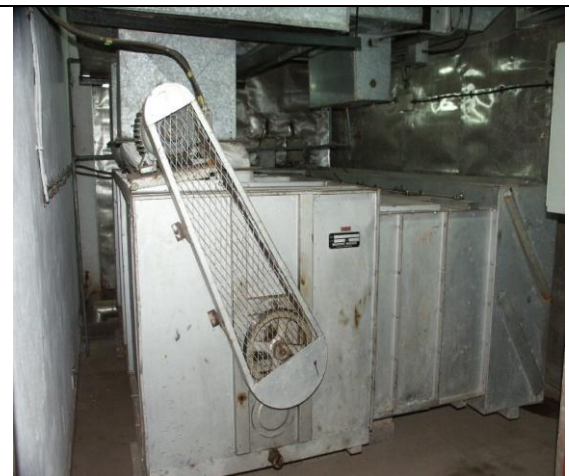
Air Handling Unit (before)
