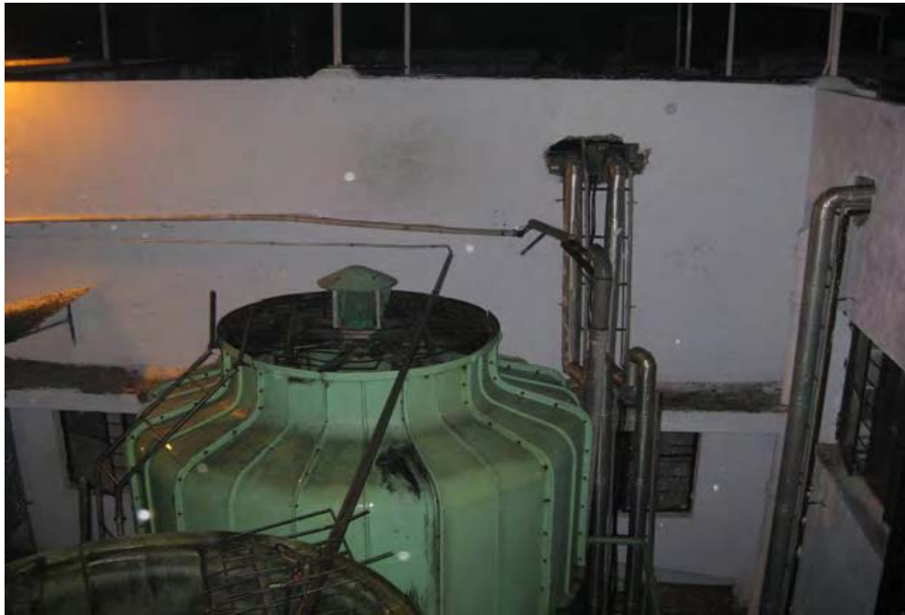
FRP Fan 4 blades 2 Nos Cooling Tower
