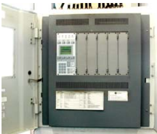
EST MAIN Panel
