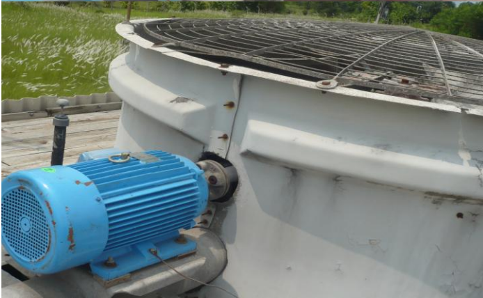
COOLING TOWER FAN NO-2.
