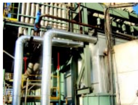
Make up water Heater in BHEL HRSG - CPP
