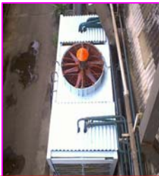
FRP CT Fan
