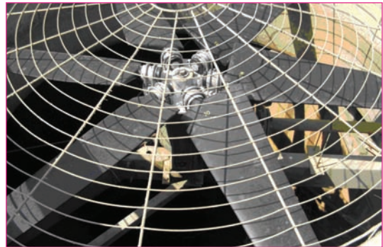
▲ New FRP Fan Blades Of Cooling Tower
